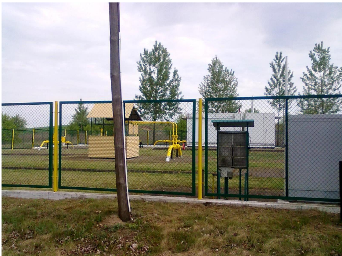
Ryc. 5 Widok stacji redukcyjnej gazu od strony osiedla zabudowy wielorodzinnej przy drodze Izbica Kujawska – Topólka
