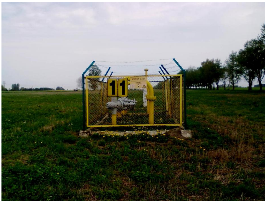
Ryc. 19 Stacja redukcyjna gazu między Izbicą Kujawską a Lubrańcem stanowi drugą nitkę wspomagającą procesy gazyfikacji gminy
