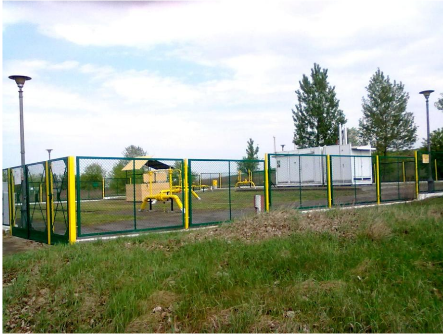
Ryc. 18 Stacja redukcyjna gazu w Izbicy Kujawskiej gwarantujące pełne pokrycie gazu na potrzeby gminy i terenów ościennych
