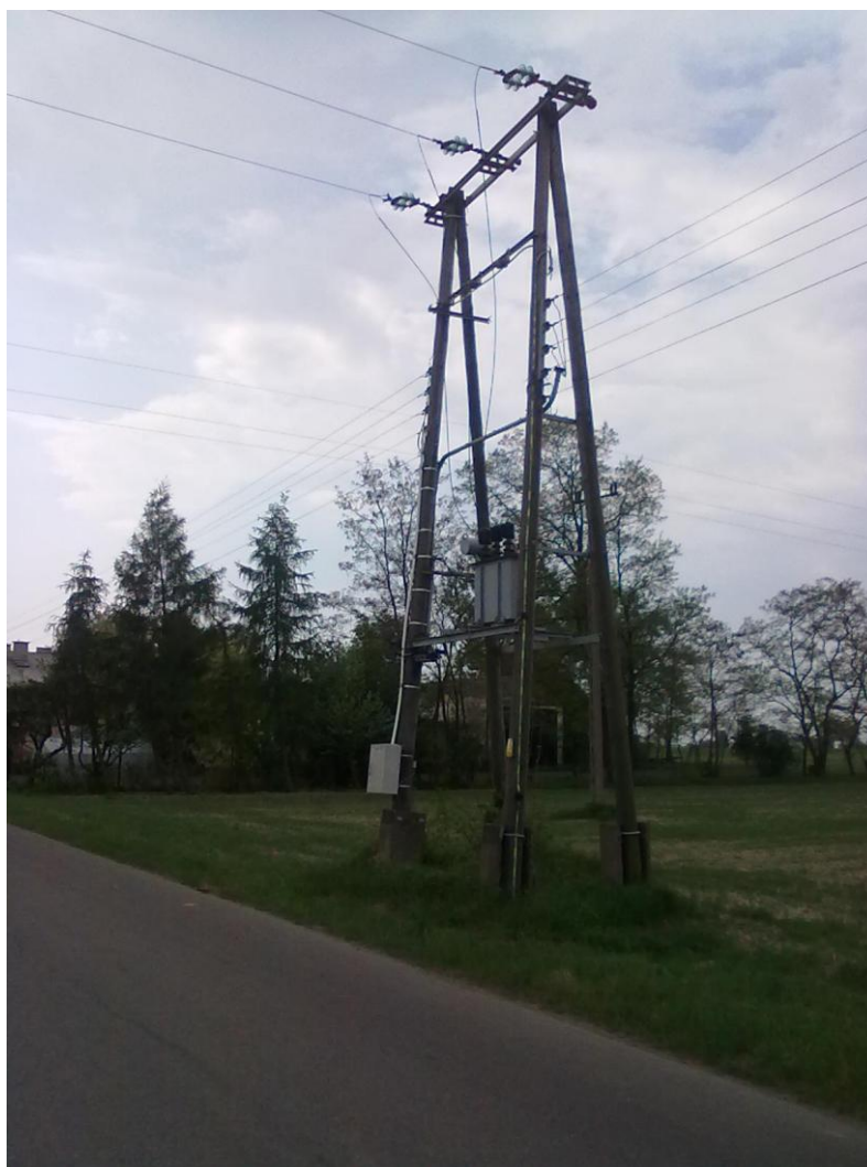
Ryc. 6 Widok stacji transformatorowej typ STS 20/250 – konstrukcja 2-ga połowa lat 70-tych XX ( żerdzie stacji drewniane na szczudłach żelbetowych, widoczne elementy osprzętu i aparatury Nn.
