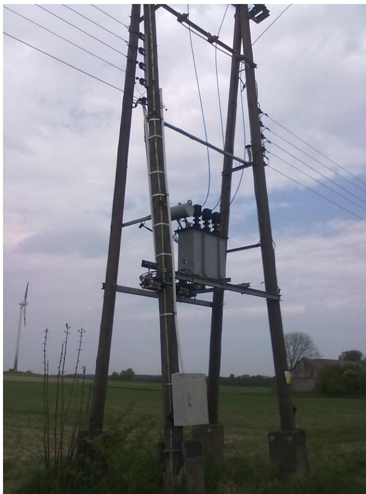
Ryc. 12 Stacja energetyczna STSa 20 / 250 na żerdziach drewnianych z ustojami żelbetowymi pamiętająca czasy doelektryfikowania kraju po częściowej modernizacji
