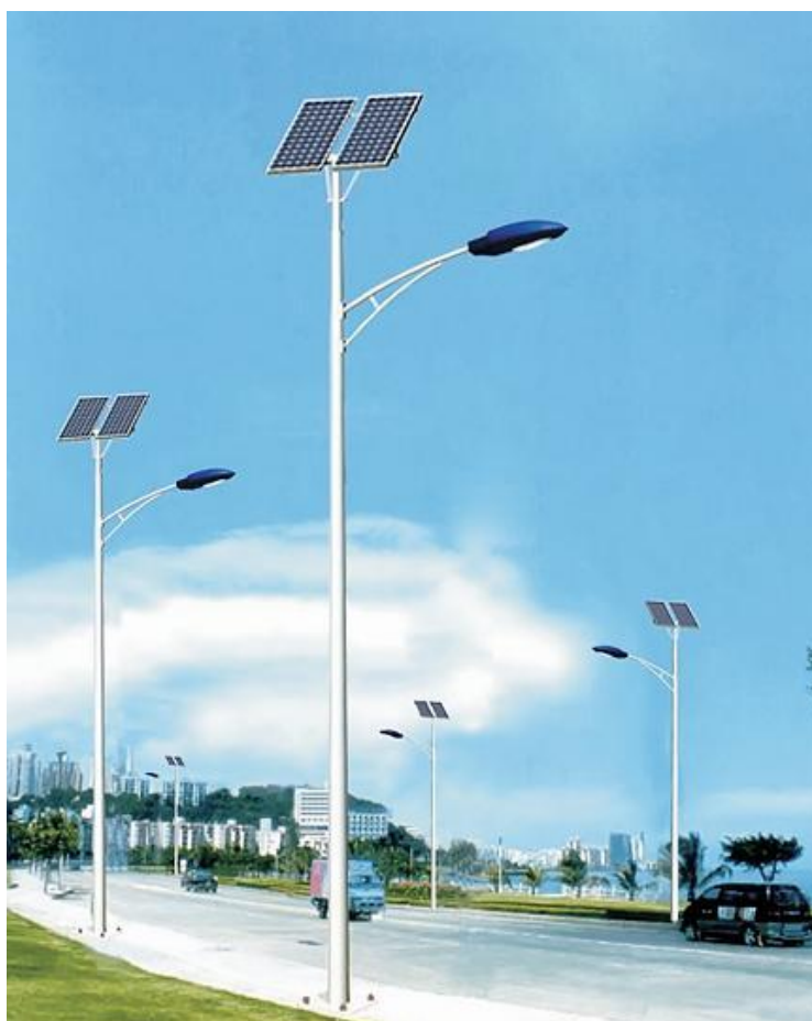
Ryc. 32 System nowoczesnego rozwiązania ulicznego wykonanego z opraw typu LED i zasilanych energią elektryczną pochodzącą z paneli fotowoltaicznych źródło ELGO Gostynin
